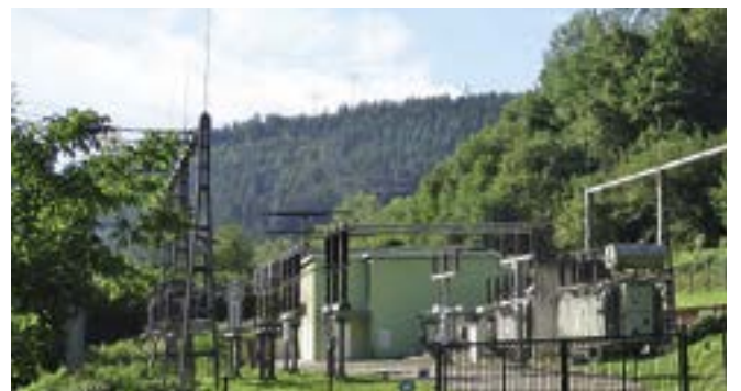
Auf dem seit 1974 zu Wildbad gehörenden ehemaligen Markungsteil des zuvor bis zum Calmbächle reichenden Schömberg befindet sich oberhalb der letzten Wohnhäuser heute ein Umspannwerk, in das auch der Strom der Windräder vom Kälbling eingespeist werden soll.
